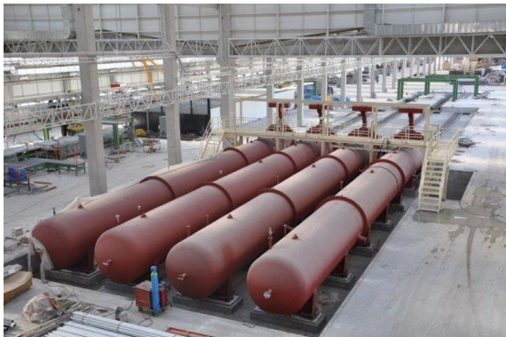
Abbildung 4-2 Autoklaven in einem Betonwerk (Länge ca. 30m)
