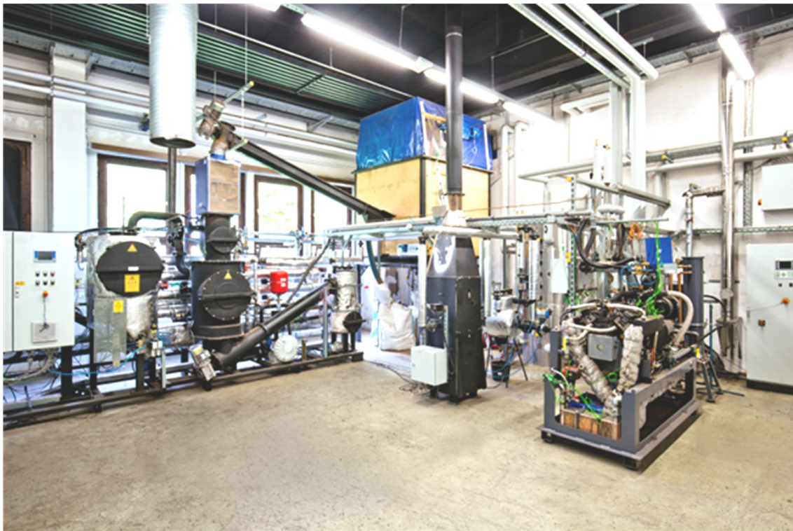
Abb. 4-23 Übersicht des Holzgas-Blockheizkraftwerks
