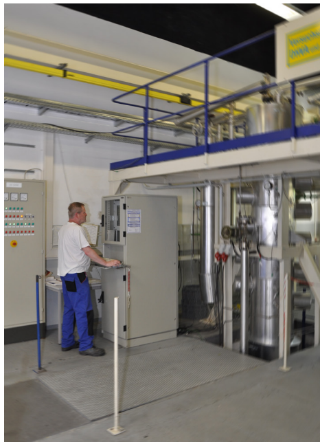
Aufnahme des Versuchsstandes Image of the test facility
