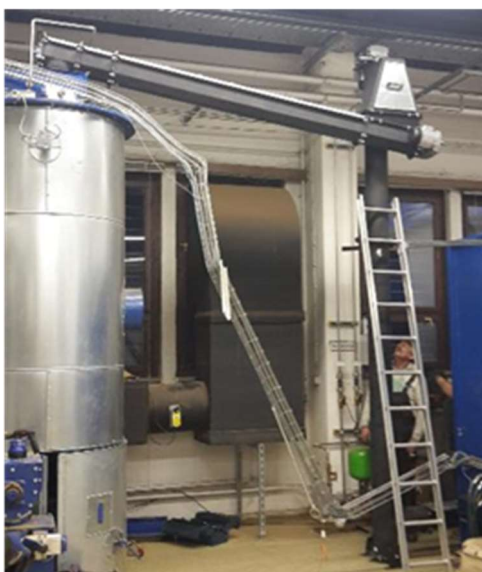
Abb. 2-10 neu installiertes Schneckenfördersystem
