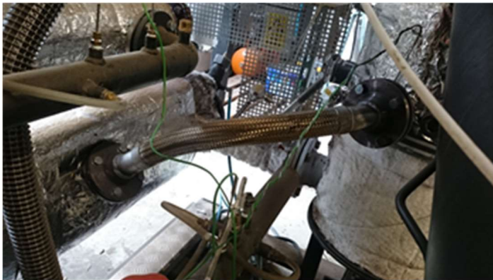
Abb. 2-16 Bisherige Vergasungsluftzufuhrstrecke (Flexschlauch) zwischen „Gas-Gas-Wärmeübertrager“ und Reformer
