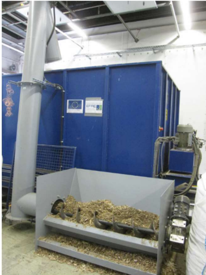
Abb. 2-7 HHS-Transportsystem zur Befüllung des Schubbodencontainers
