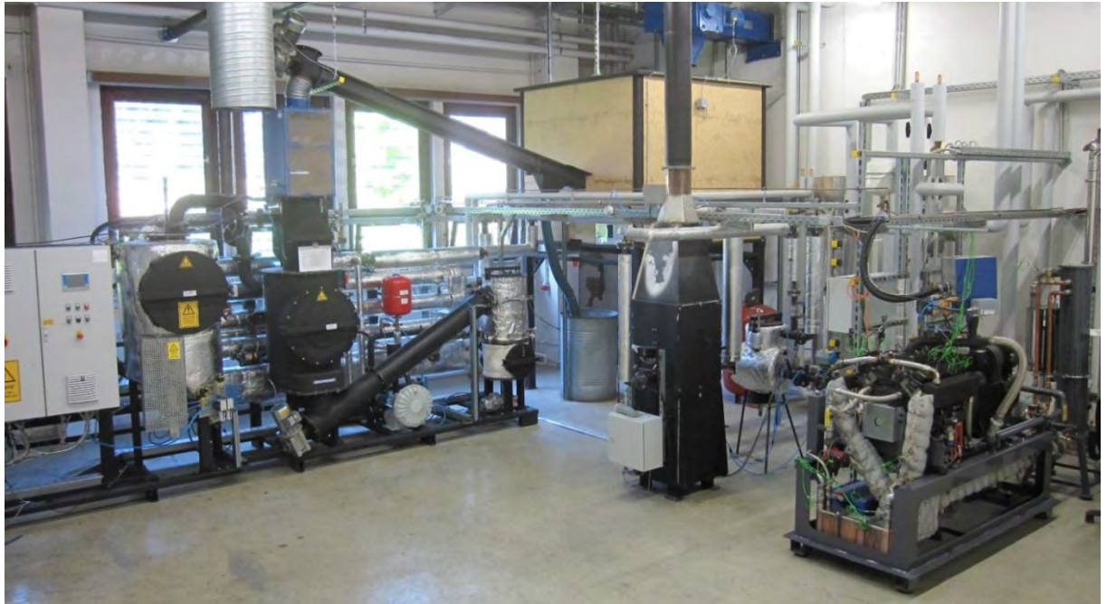
Abb. 4-26: Übersicht des Holzgas-Blockheizkraftwerks
